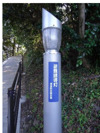
【4-3】避難誘導灯 [*JPG]
