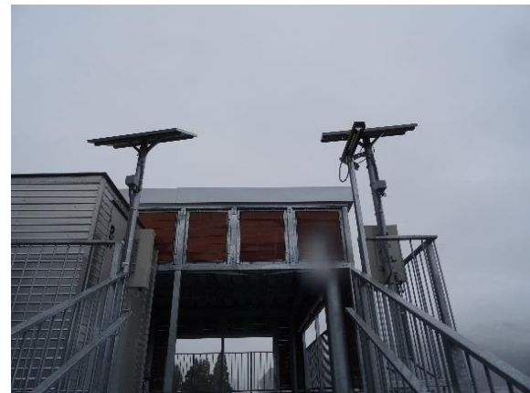
【5-19】太陽光発電式照明 [*JPG]
